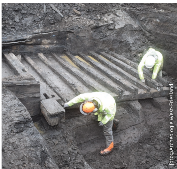
Door een van de wanden van de sluis te ontmantelen, kon een groot deel van de sluis worden onderzocht.
