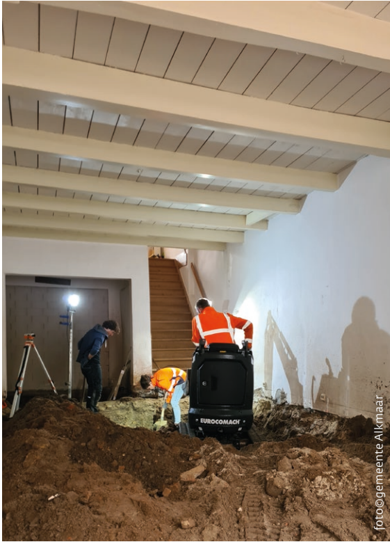
Graafwerk in het achtervertrek met inzet van een kleine graafmachine. In de balklaag erboven is de raveling te zien voor een schouw tegen de zuidelijke zijmuur.
