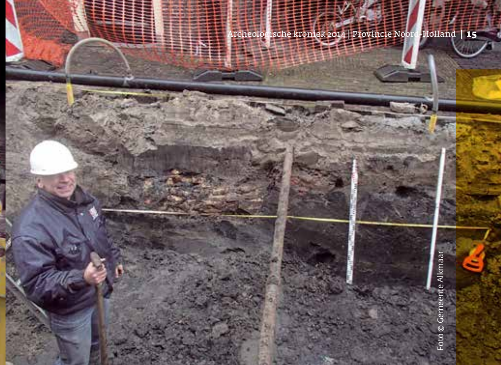
In de noordwand wordt links de ophoging van rond 1290 doorsneden door de beerput en rechts is de steilkant te zien met de 14de-eeuwse opvulling van bruine klei en mest, met de huisfundering erbovenin.
