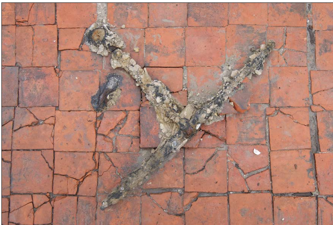
Afb. 5.9.13 Op de plavuizenvloer lag een ijzeren muuranker.
