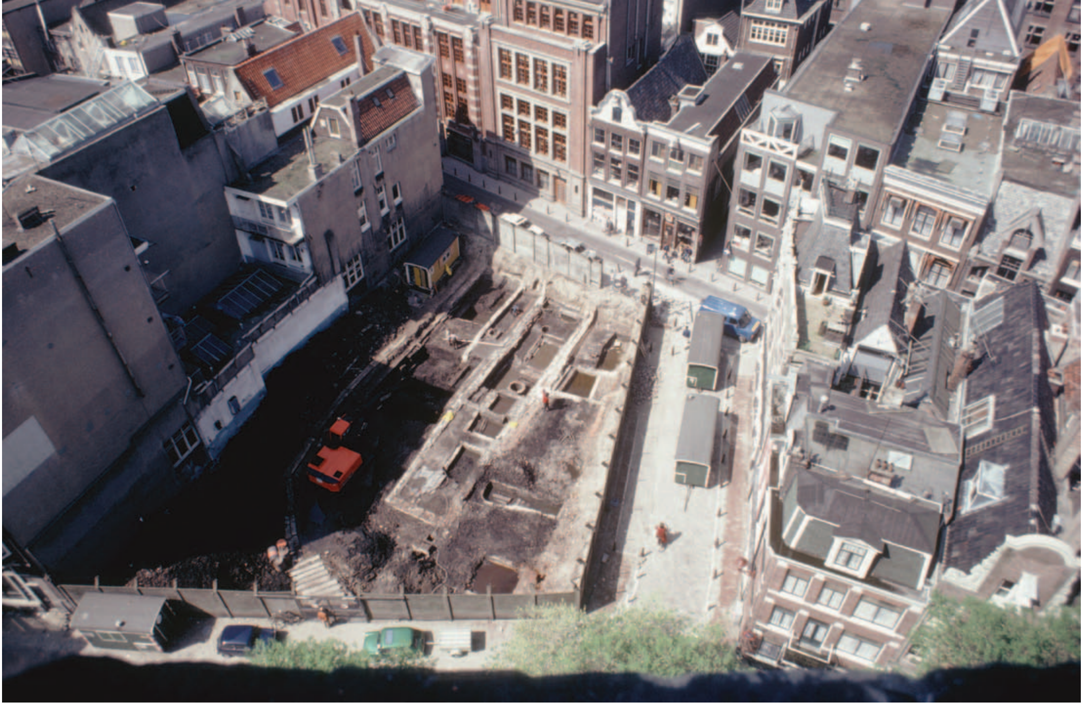
Uitzicht vanuit de toren van de Oude kerk op de opgraving Warmoesstraat in 1983. Ter hoogte van perceel 105 (zie foto pagina 27) zijn fundamente uit de veertiende eeuw zichtbaar
