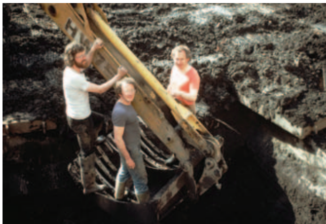
In de bak van de kraan dalen Jaap Kottman, Ab Lagerweij en Jan Baart af in de werkput aan de Nieuwendijk
