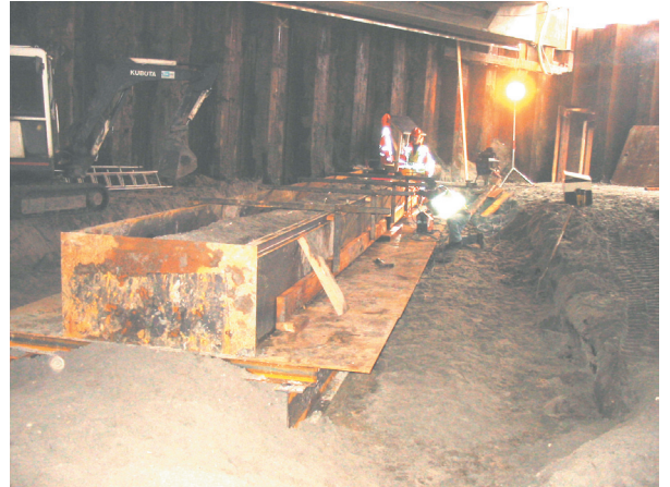
Figuur 33 Boven de stalen balken werd de grond eerst losgezaagd, waarna er een stalen onderplaat in werd geschoven. Dit vormde het meest risicovolle deel van de bekisting, aangezien de grond om de kano had kunnen instorten. Alles verliep echter volgens plan.
