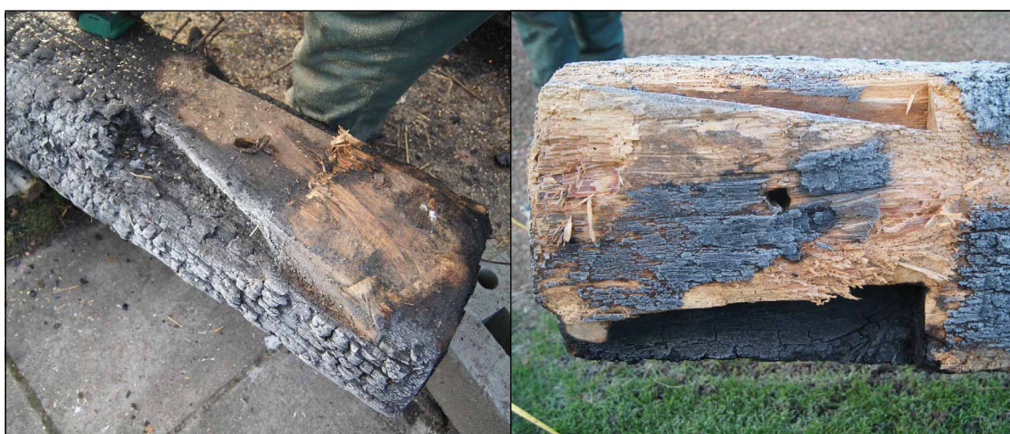
Afb. 50 Zwaluwstaartvormige uitsparingen aan de bovenzijde van een onderste dekbalk en een bovenste dekbalk.
