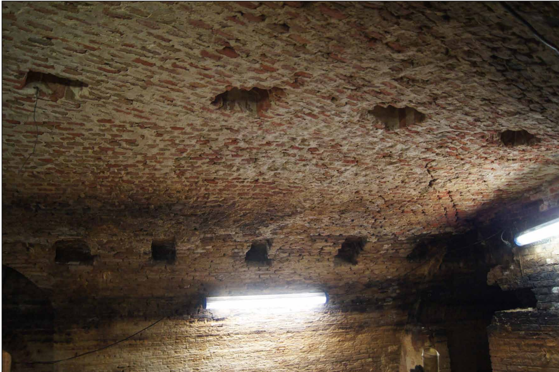
Afb. 34 Gaten in de zuidwestzijde van het tongewelf van de geschutskelder.
