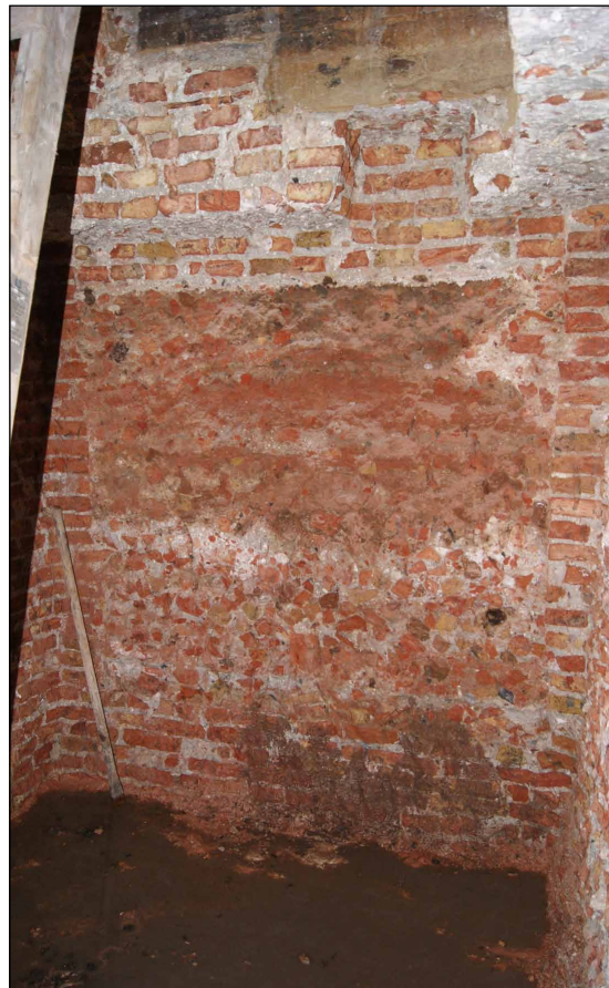
Afb. 53 Na het wegbreken van de onderste helft van de trap kwam dit kistwerk tevoorschijn in de zuidmuur. De muur is hier gedeeltelijk opgebouwd uit brokken baksteen en mortel.
