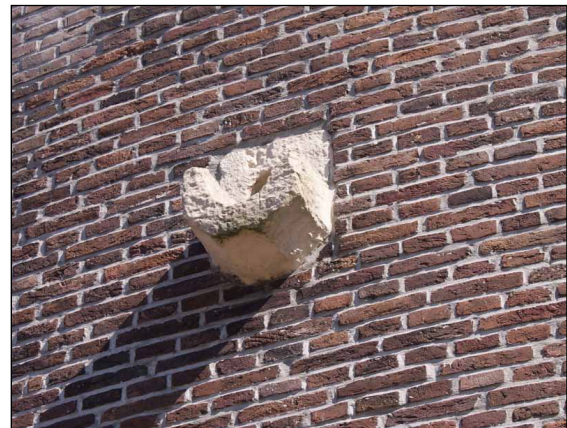
Afb. 15 De enige resterende waterspuwer van het dak van het grote rondeel.
