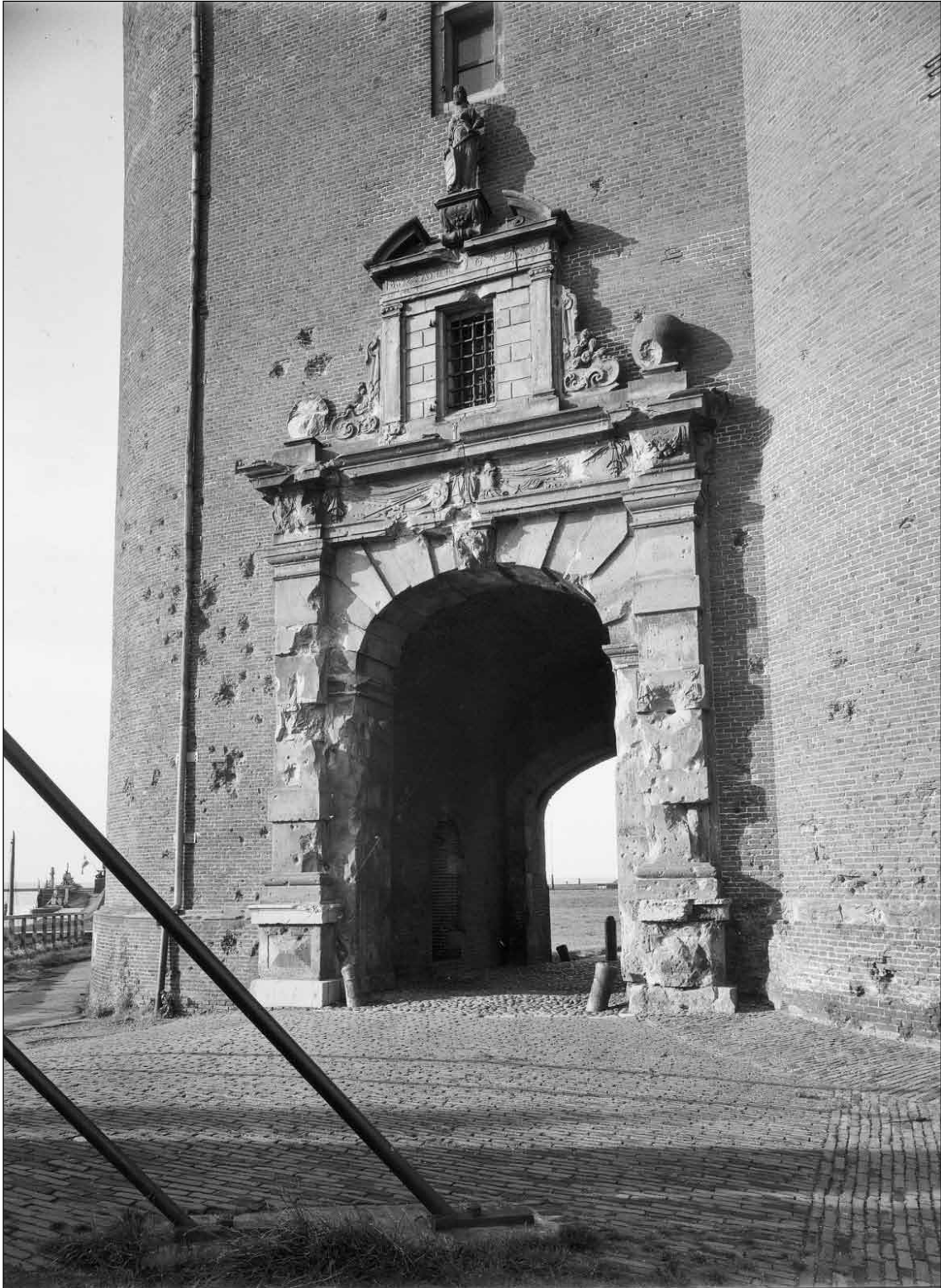
Afb. 26 Schade aan het noordportaal, ontstaan tijdens de Tweede Wereldoorlog. Foto uit 1950. Collectie RCE.
