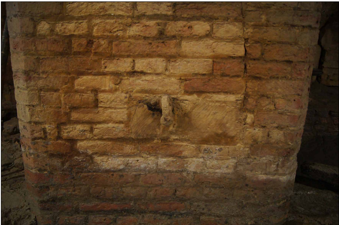
Afb. 46 Een ijzeren oog van een verdwenen ring in de muur tussen geschutsnis 4 en 5.
