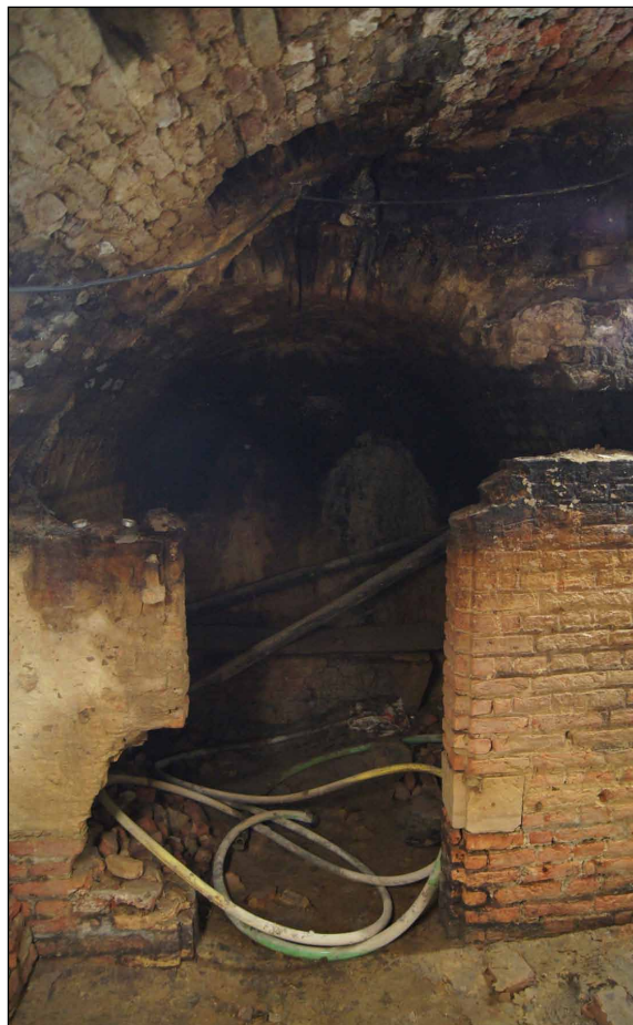
Afb. 57 Gevangenis 2. De bovenzijde van de deuropening is in het verleden deels weggebroken.
